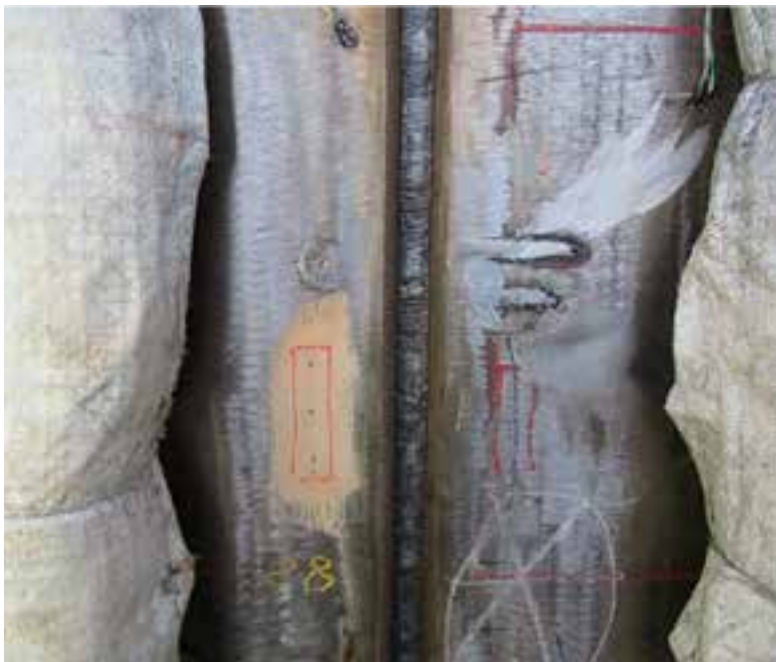
Soudage en cours de la partie avant du SNA Saphir et de la partie arrière du SNA Perle pour reconstituer le SNA Perle réparé ; figurent de part et d'autre des tapis chauffants pour maintenir l'acier spécial de coque à température avant et après soudage et éviter la formation de fissures à cœur
