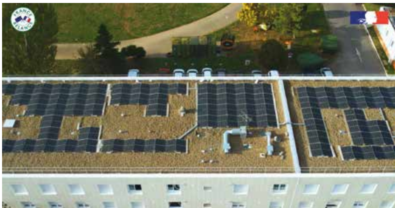
Installation solaire photovoltaïque du Contrat de Performance Energétique de la caserne Marescot – 31èRG – Castelsarrasin (82).
