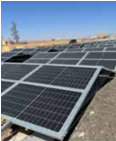
Centrale électrique hybride (thermique/solaire).
